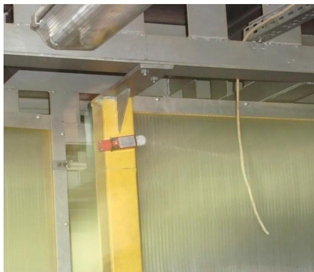
Rys. 5. Obchodzenie urządzeń ochronnych
